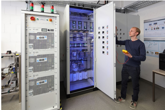
Abb. 3 Arbeiten am zentralen Verteilerschrank des DC-Testnetzes am Fraunhofer IISB.
