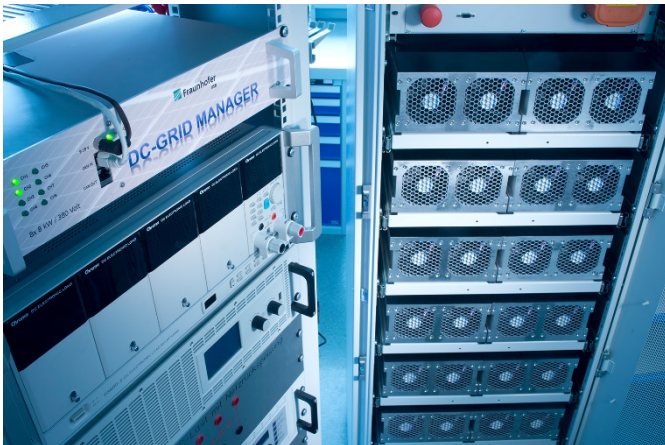
Abb. 2 Leistungselektronische Wandler und stationäres Batteriespeichersystem am Fraunhofer IISB.
